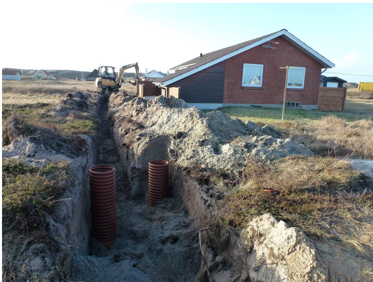
Her ses en lodsejerbrønd og at stikledningen føres ind til ejendommen.
